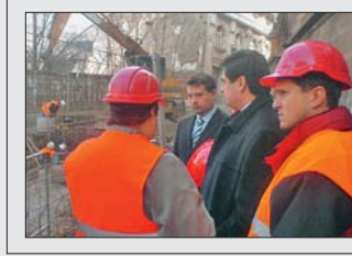
Primátor se zajímal o průběh rekonstrukce staveniště v ulicích Denisova a Pekařská absolvoval v polovině března primátor města Martin Novotný v doprovodu investičního náměstka Martina Majora a zástupců zhotoviteléské firmy.
